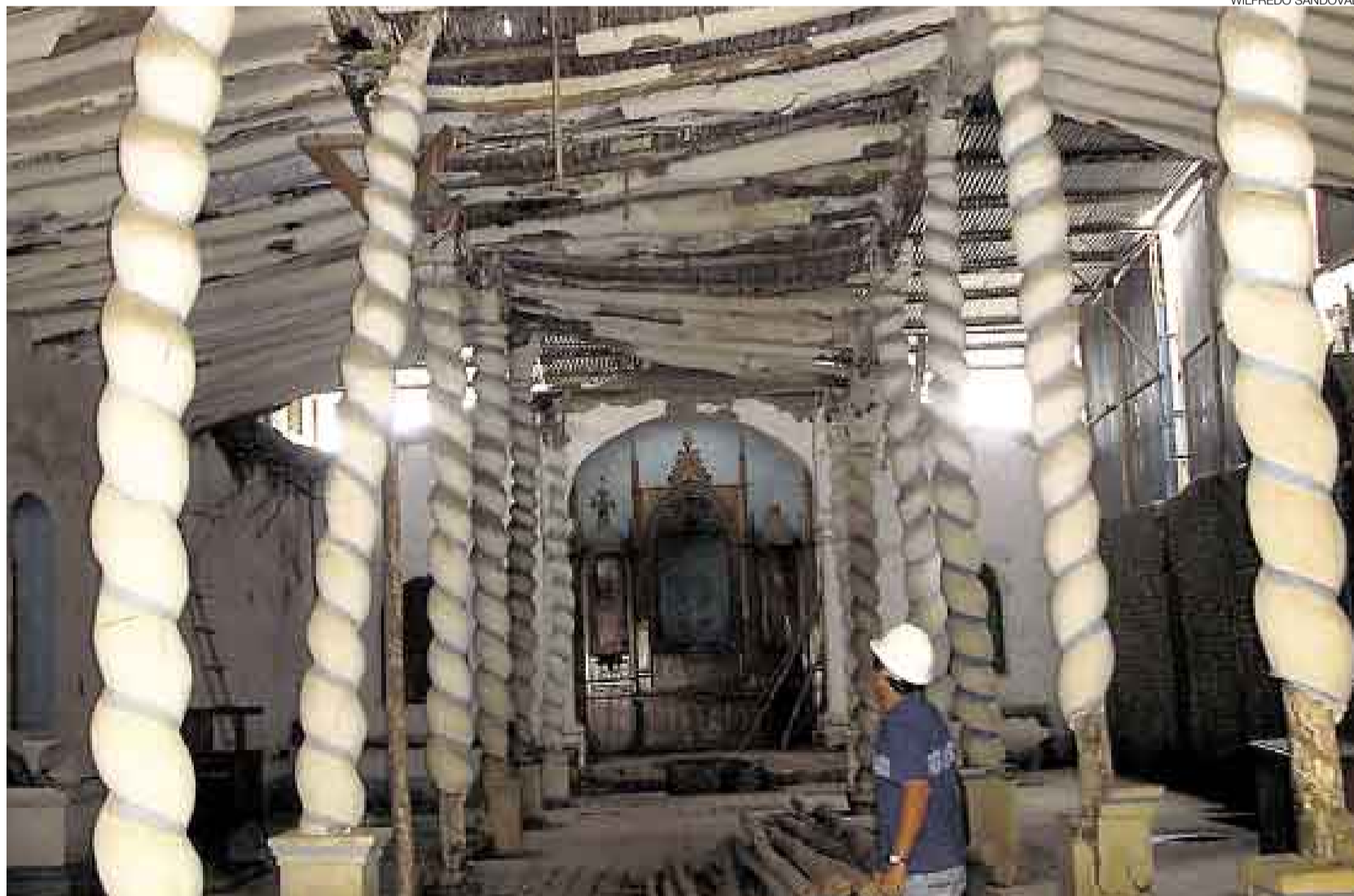
RESISTE. La bóveda y muros del recinto, dañados por el paso del tiempo, volverán a lucirse. La inversión sobrepasa los S/.460 mil.
