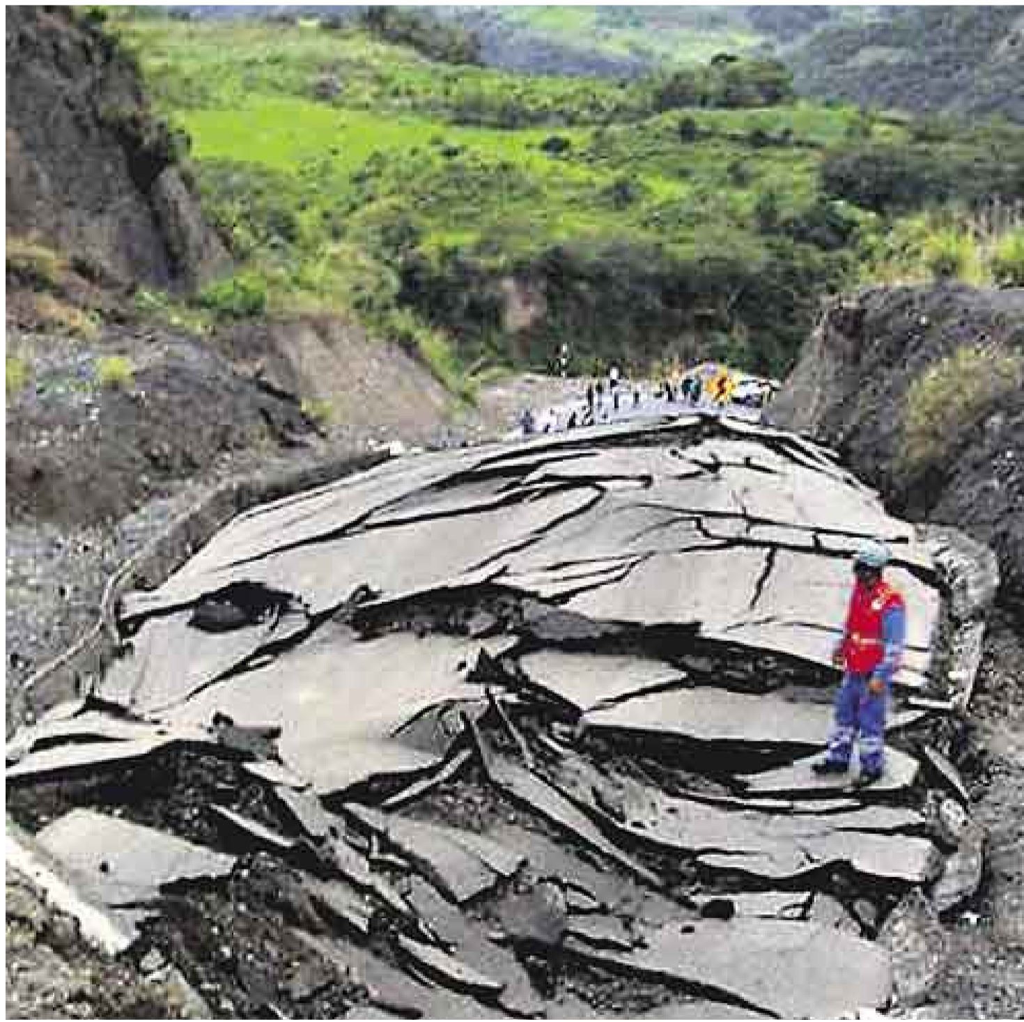
QUEBRADA. Así quedó la vía Fernando Belaunde, a la altura del km 265, en la provincia de Utcubamba. Parte del cerro adyacente se ha desprendido.
